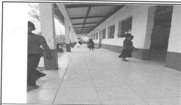
Piso cerámico del corredor
